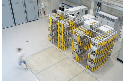
Mittelspannungsprüffeld bis 30 kV Spannung und 20 MVA Leistung für die Charakterisierung leistungselektronischer Systeme für Energietechnik, Mobilität und Luftfahrt.
