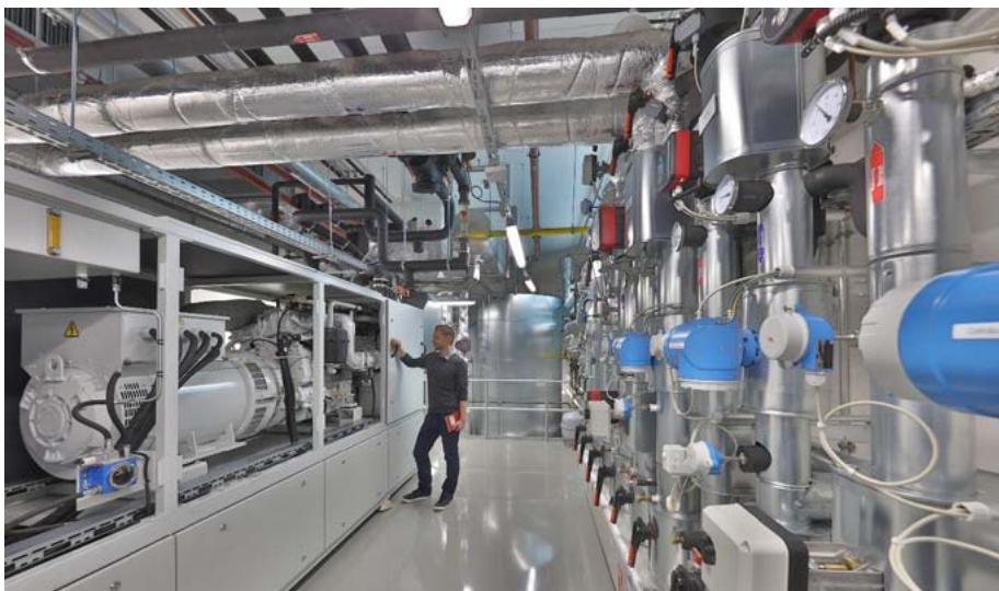
Blockheizkraftwerk und Warmwasserspeicher im Untergeschoss des Fraunhofer IISB: Die Kraftwärme-Kopplungsanlage wurde im Rahmen des Erweiterungsbaus B in die Infrastruktur des Instituts integriert. Dort wird sie sowohl zur Wärme- und Stromversorgung als auch als Forschungsanlage genutzt. Bild: Kurt Fuchs / Fraunhofer IISB
